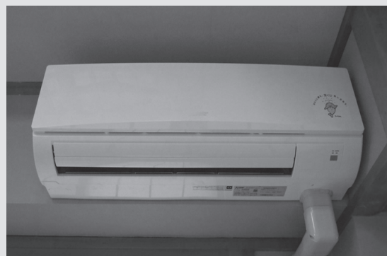
▲整備したエアコン
