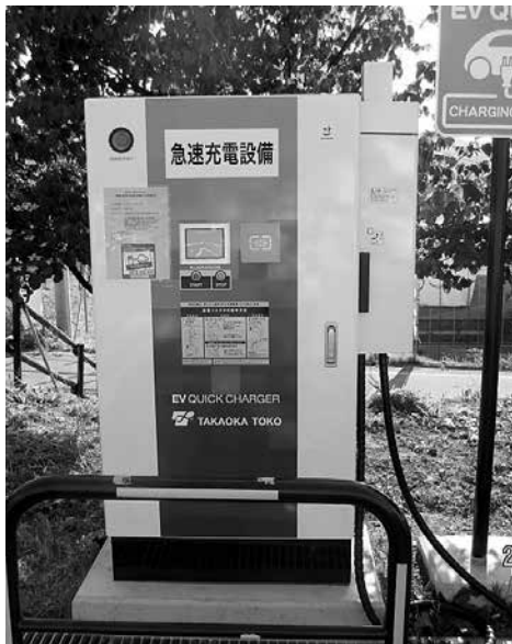
道の駅に設置した急速充電設備
