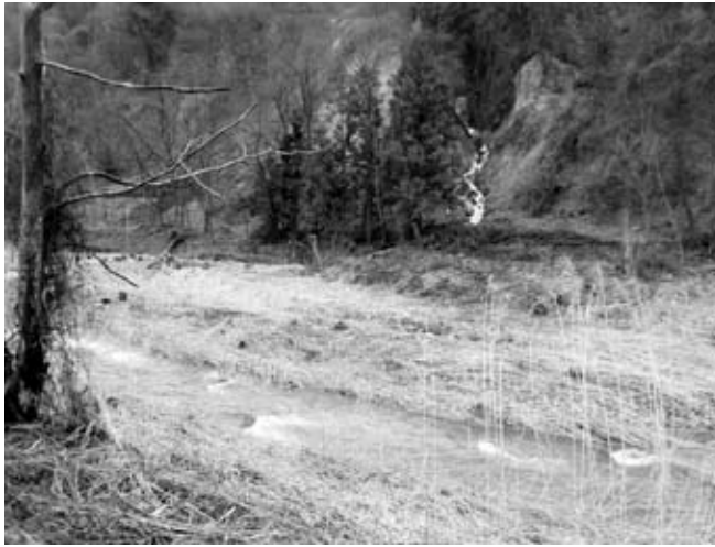
角間橋上流の危険箇所
