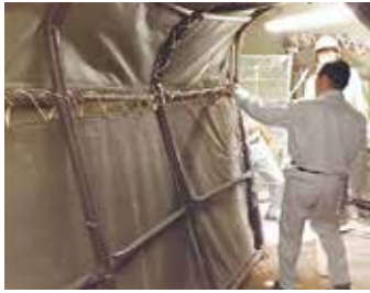
雪の重みで曲がったトンネル通路
