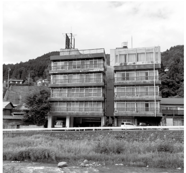
町道にタイルなどが落下する危険な空き家
