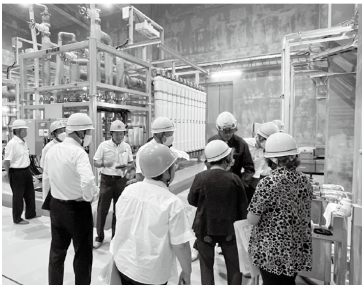
PFASも除去できるRO（逆浸透膜）が設置されている東部浄水場の視察風景
