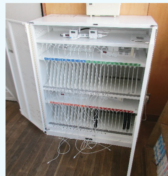
廊下に設置された充電装置
