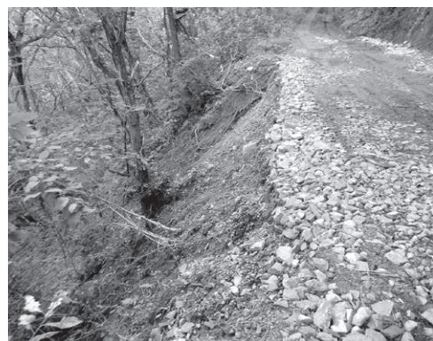
8月豪雨による災害箇所（金倉竜王線）
