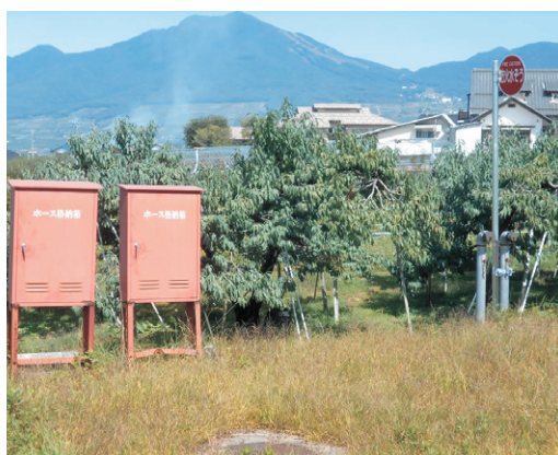
寒沢地区の埋設型の防火水槽（40㎡）
