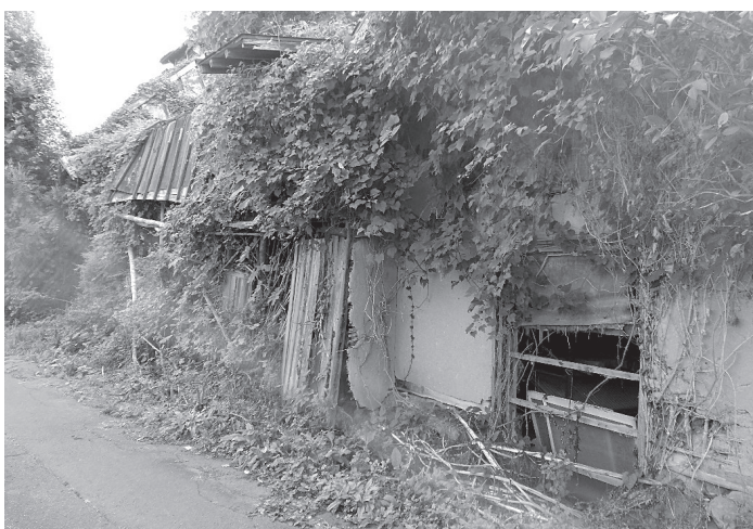
早期対策が望まれる管理不全な空き家
